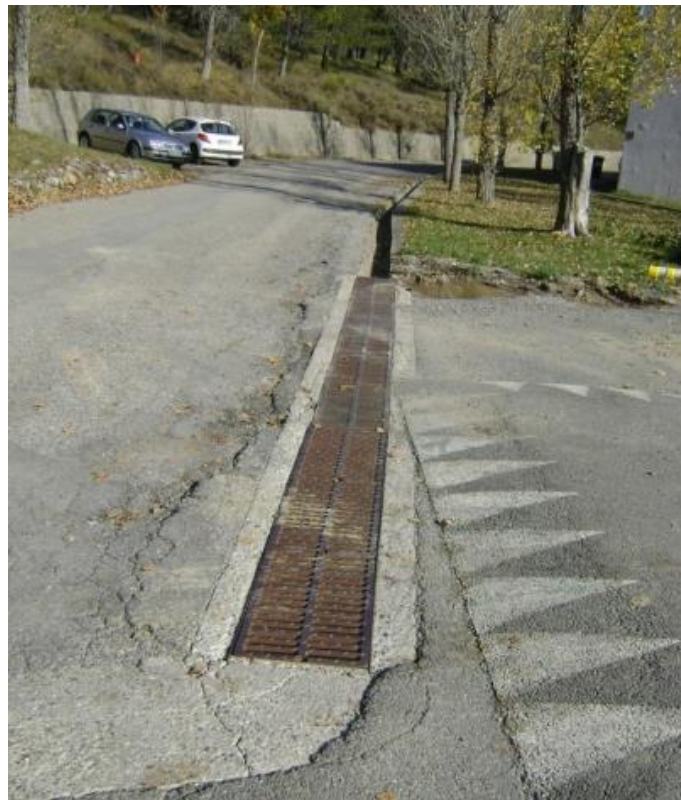
Illustration 18 : Photo du caniveau-grille prolongé d'un caniveau béton entre les bâtiments « Blanchisserie » et « Adret » (source : Etude sol Concept, 2021)
