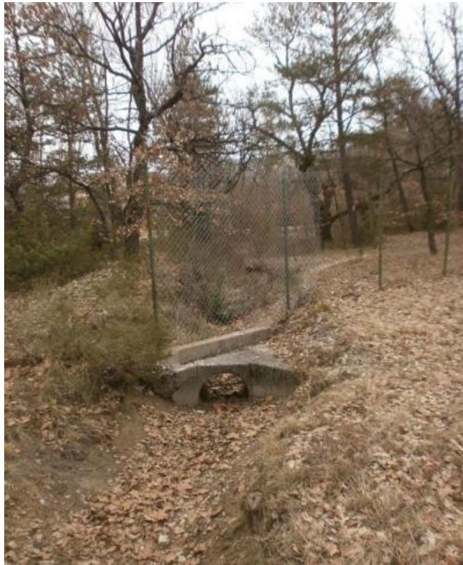
Illustration 19 : Photo d'une buse au niveau au sud-est de la clôture d'enceinte du site du Centre Hospitalier vers le ravin St-Martin (source : Etude sol Concept, 2021)
